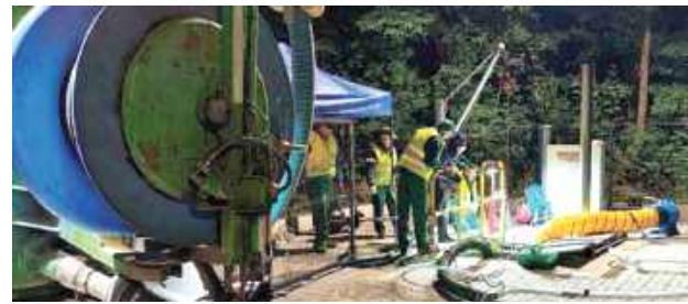
Podczas czyszczenia z wnętrza przepompowni usunięto nagromadzone zanieczyszczenia stałe, przede wszystkim zbite włókny, takie jak szmaty czy chusteczki nawilżane. Tego typu odpady nie powinny trafiać do kanalizacji, ponieważ utrudniają pracę urządzeń i mogą prowadzić do kosztownych awarii
