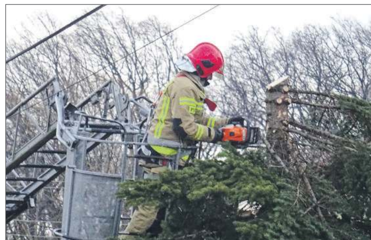
Na ul. Jesiennej w Dębicy drzewo spadło na kabel.
