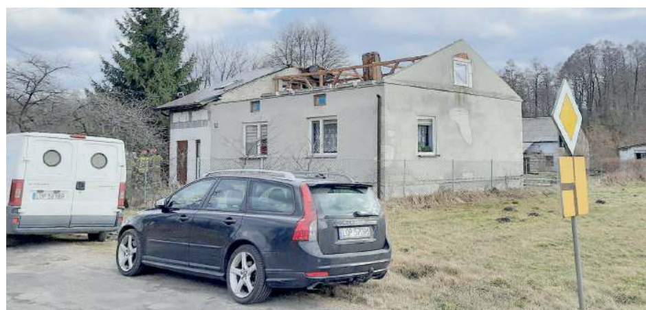
Do najpoważniejszego w skutkach zdarzenia doszło we wsi Dębiny (gm. Opole Lubelskie). Porywisty wiatr zmiotł z domu dach, który następnie spadł na stojące w pobliżu samochody i uszkodził je
