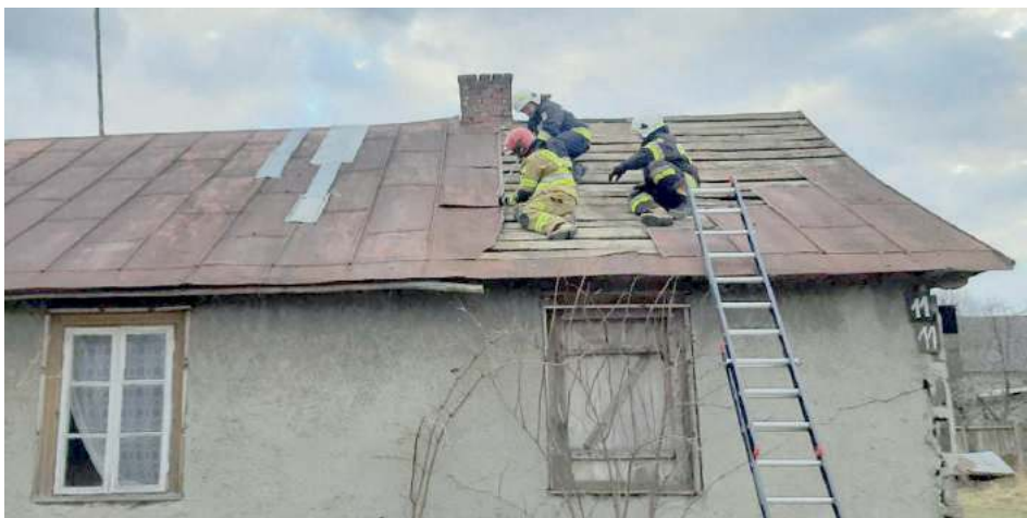
GMINA SEROKOMLA W sobotę, 19 lutego, w Józefowie Dużym wiatr zerwał z domu poszycie dachowe. We współpracy z PSP Łuków strażacy OSP Serokomla zabezpieczyli dom przed dalszymi skutkami wichury
