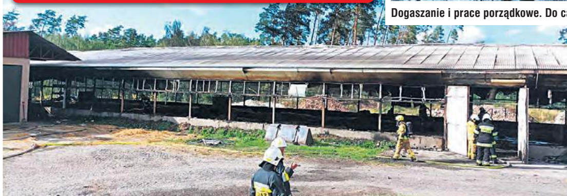
Pozostałości po kurniku, który spłonął w piątek na fermie drobiu w Gostycynie. Fot. KP PSP Tuchola
