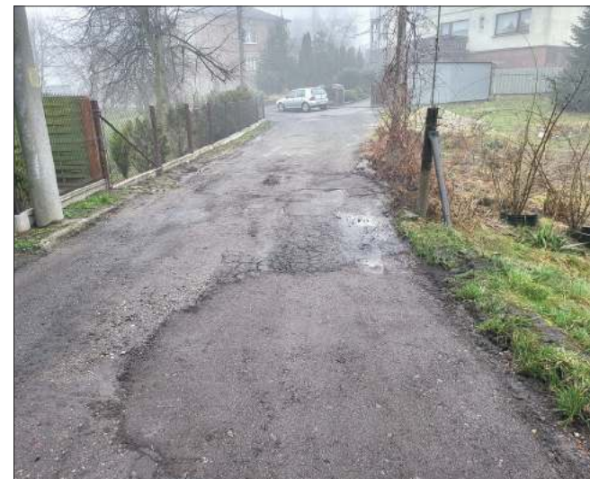
■ Po dziurze w bocznej ul. Oraczy w zasadzie nie ma już śladu, a nawet masą asfaltową wypełniono inne ubytki.
