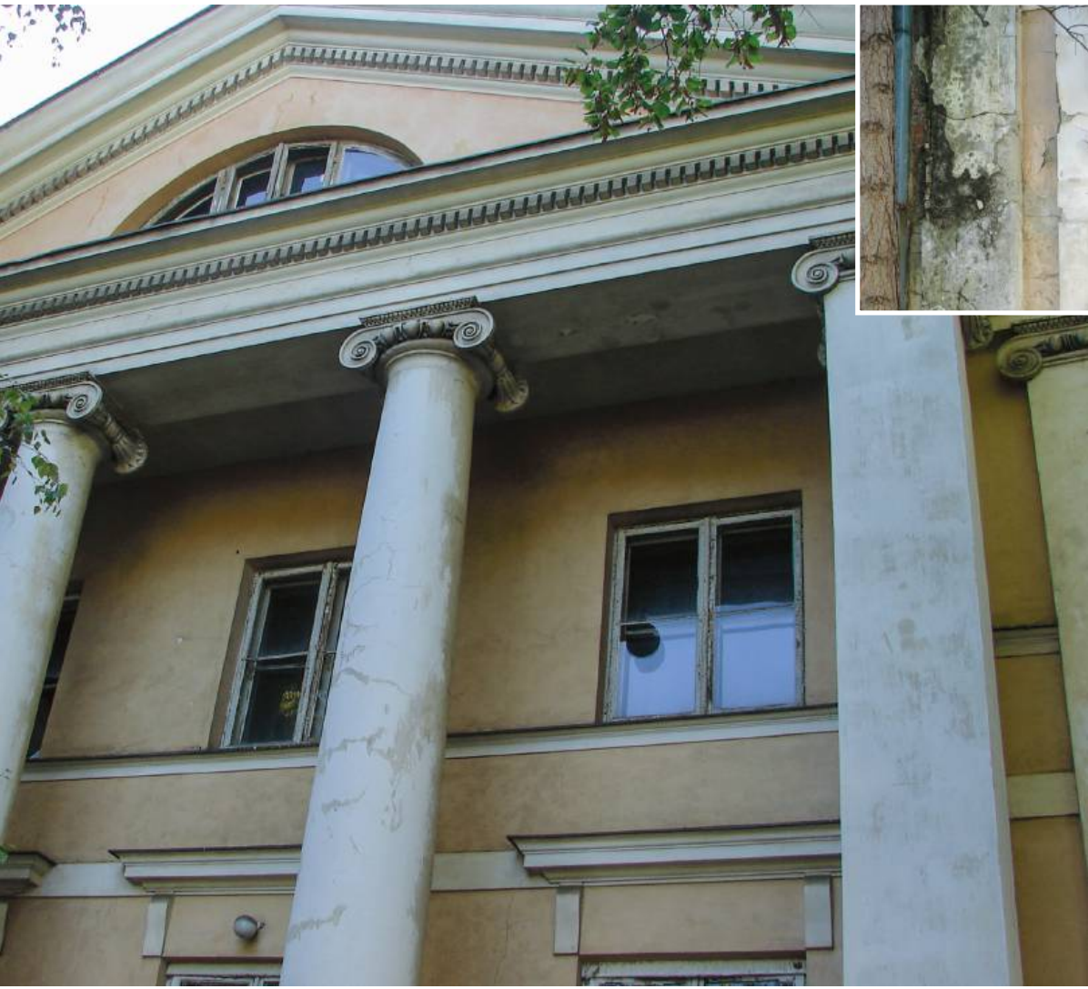
rozpadające się tynki elewacji. | fot. Janusz Sujecki/Gazeta Polska
