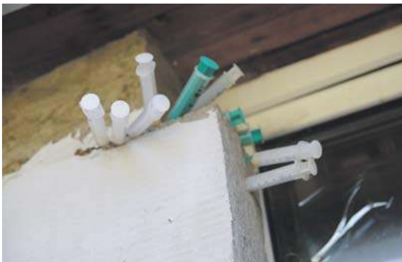
Domek w Żłożeńcu Kamil Stanek oddał właścicielowi zdewastowany. Właściciel odbierał własność w asyście policji. Zdjęcia do dzisiejszego artykułu są dokumentacją z tego przekazania
