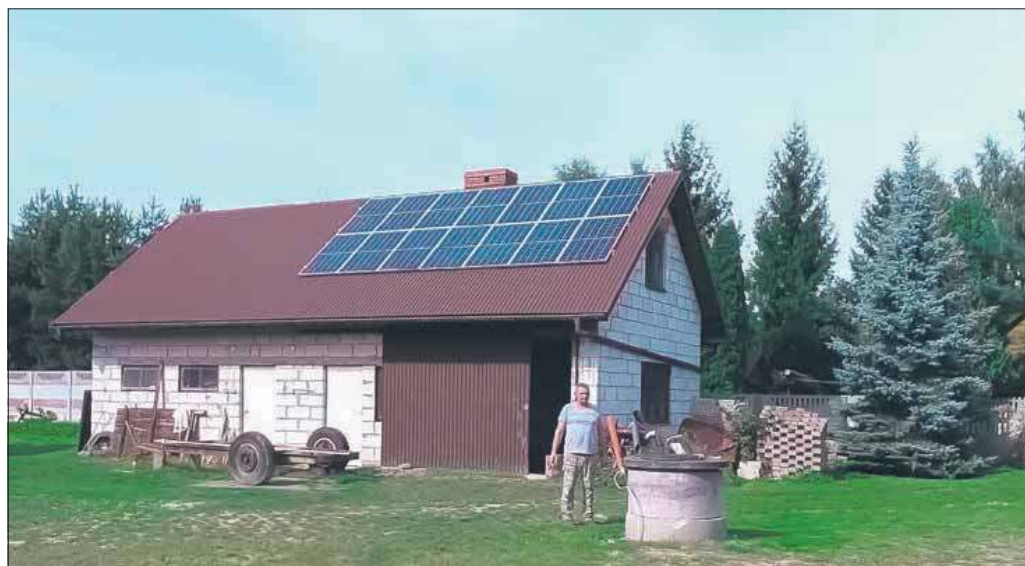
Fotowoltaika na budynku gospodarczym
