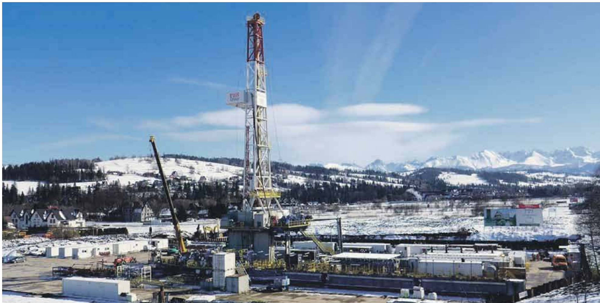
Odwiert geotermalny w Szaflarach
