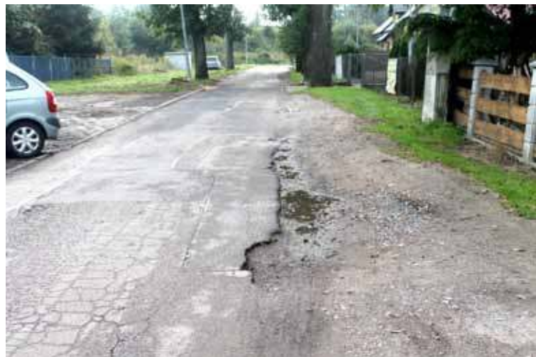
Z powodu braku chodnika, zupełnie zniszczona jest w wielu miejscach nawierzchnia drogi
