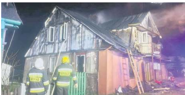
Po pożarze dom przy ul. Targowej nadaje się tylko do rozbiórki.
