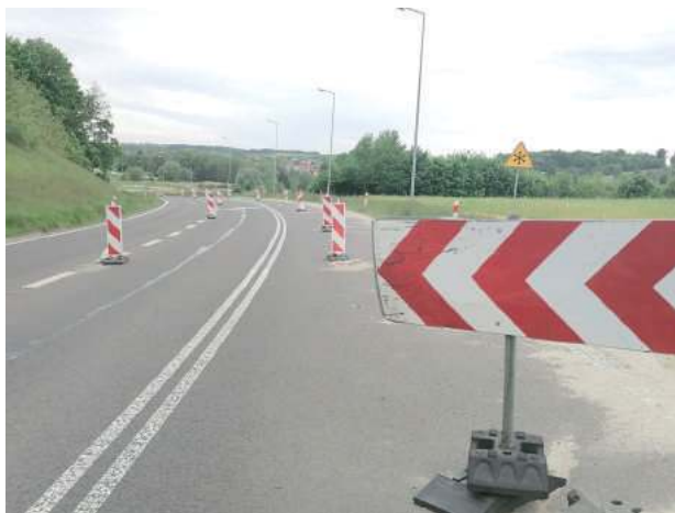
Przy prawej krawędzi drogi, osiada skarpa nasypu. - Obowiązująca tam organizacja ruchu została wprowadzona w celu odsunięcia ruchu pojazdów od prawej krawędzi jezdni - tłumaczy drogowcy
