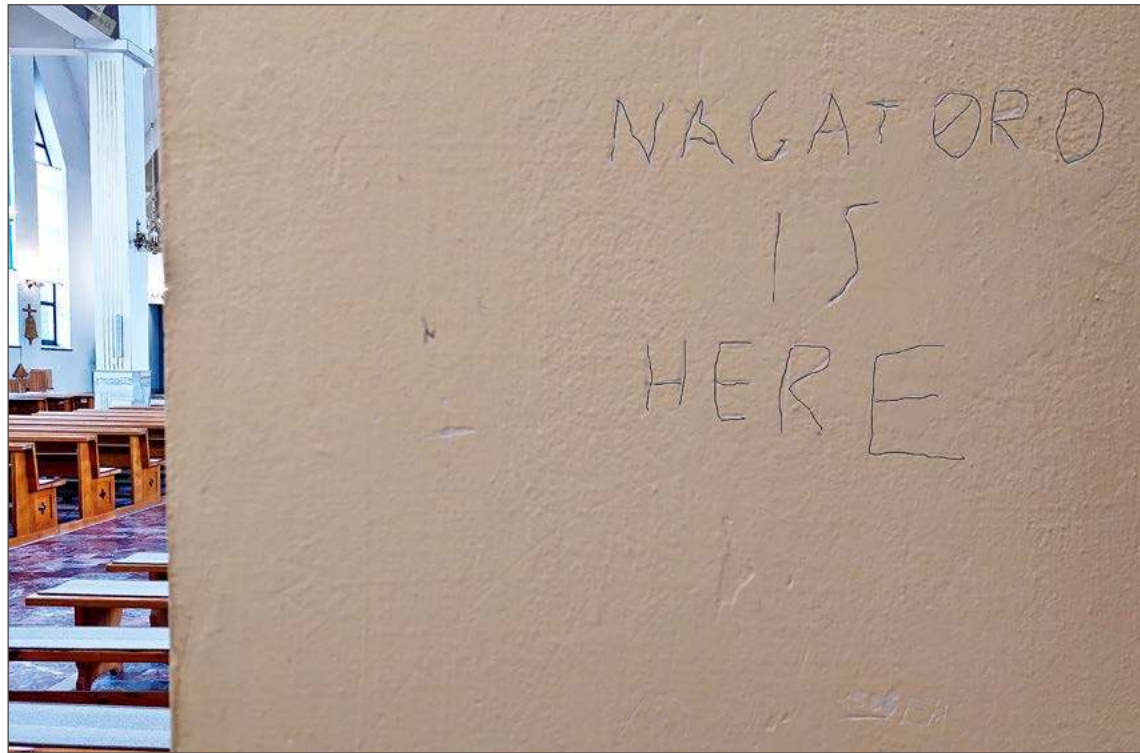
Innym przykładem nieposzanowania obiektu sakralnego jest pisanie po jego murach, tak jak wandal zrobił to w kościele w Pustkowie. Napis na ścianie jest wydrapany i wzmocniliśmy go na zdjęciu, by był lepiej widoczny.
