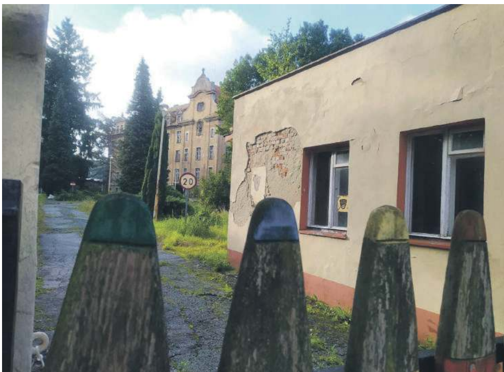
Wjazd zamknięty, tynk leci z budynków
