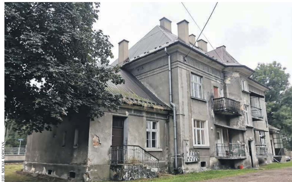
Kamienica w rejonie przystanku kolejowego w Dulowej wyczekuje na remont
