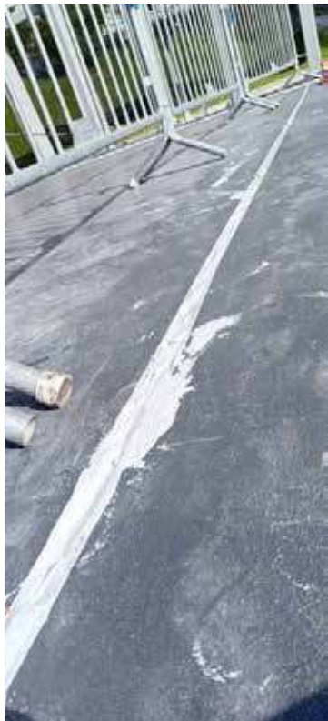
Zniszczone wypełnienie fot. ŁDK
