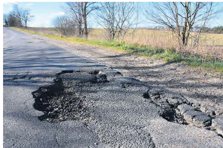
Dziury będą niebawem zalatane. Na nowy dywanik na razie mieszkańcy Wysokiej nie mają co liczyć.
