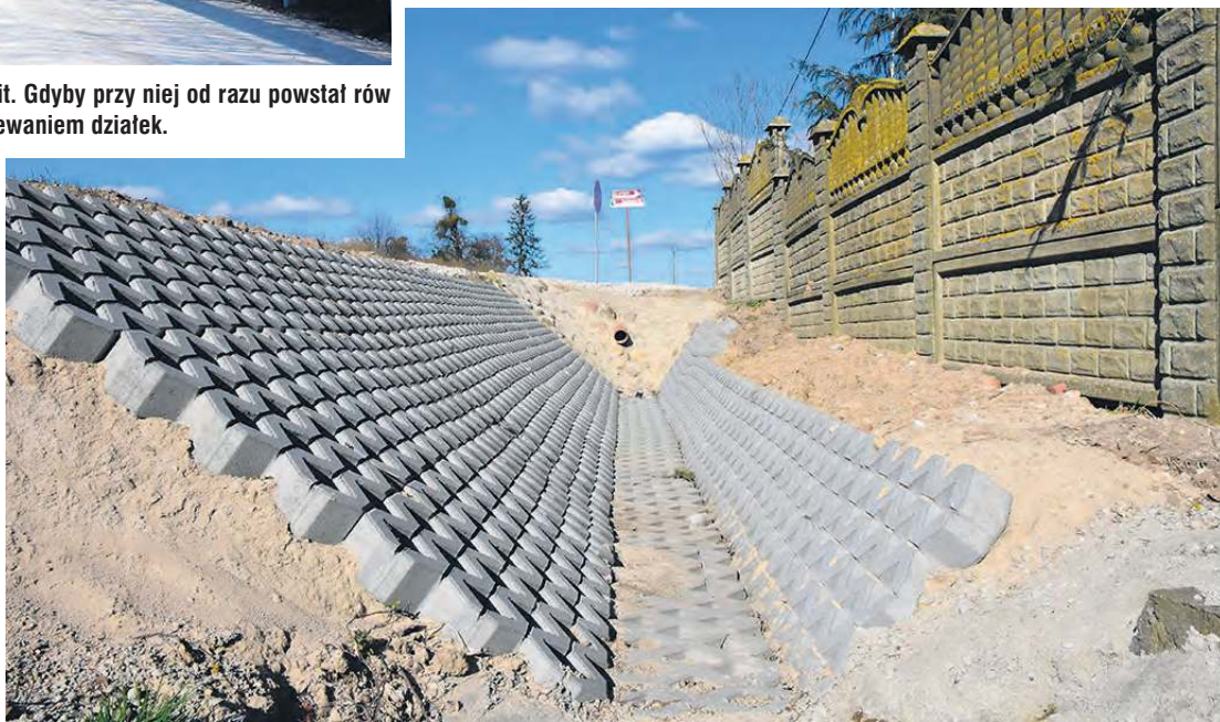
Rów chłonny odwadniający. On, zdaniem ZDW, jest wystarczający do tego, by zebrać wody opadowe z drogi wojewódzkiej.
