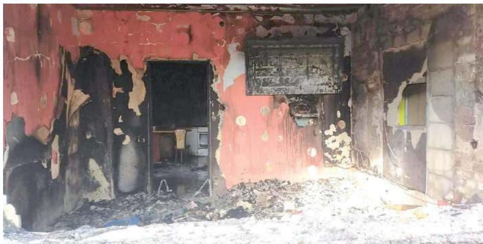
Rodzina właściwie straciła cały dobytek. Budynek w znacznej części strawił płomień. Dom wymaga generalnego remontu
