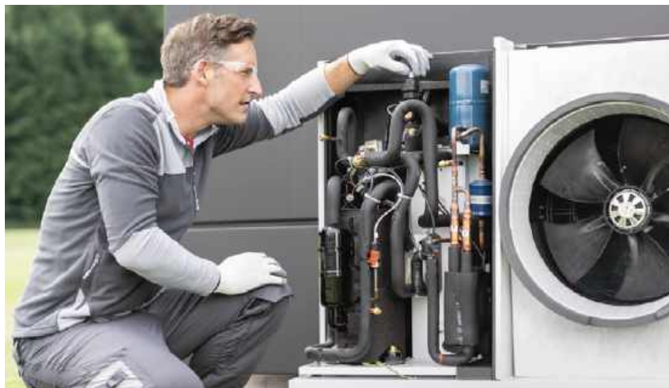
🔧 Przeglądy i naprawy pomp ciepła to zadanie dla przeszkolonych serwisantów. STIEBEL ELTRON
