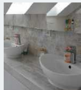
🔴 Jednouchwytowe chromowane baterie, o zaoblonym kształcie, zamontowano na umywalkach.
