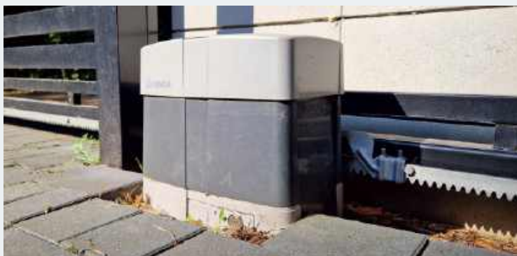
Skrzynka z motoreduktorem stoi na postumencie obok słupka z lampą ostrzegawczą.
