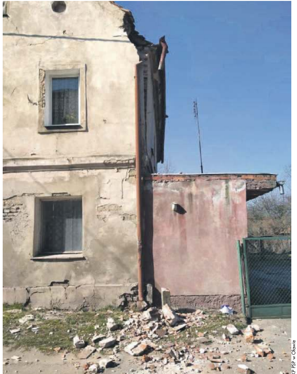
Konstrukcja budynku została poważnie uszkodzona. W górnej części widać odchyloną ścianę
