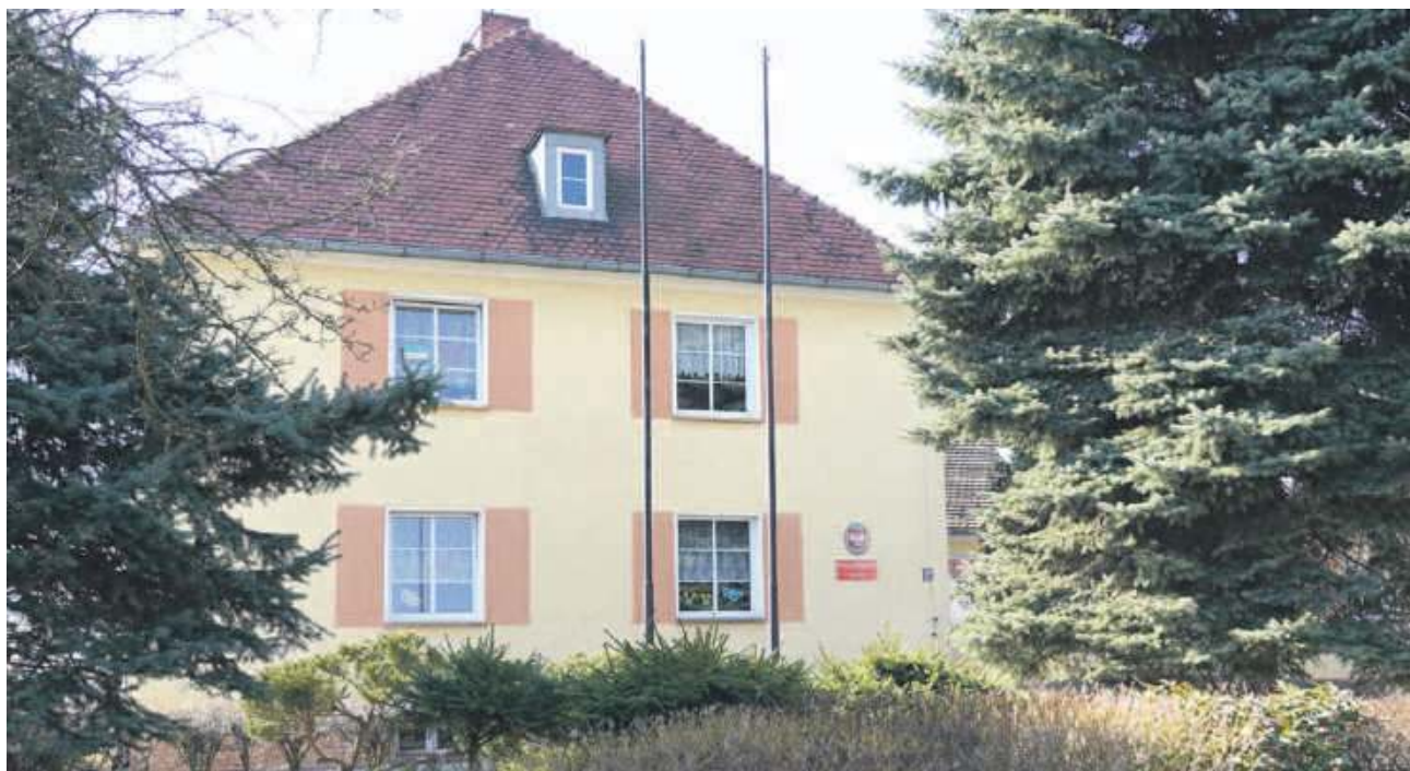
Dach tej szkoły wymaga remontu
