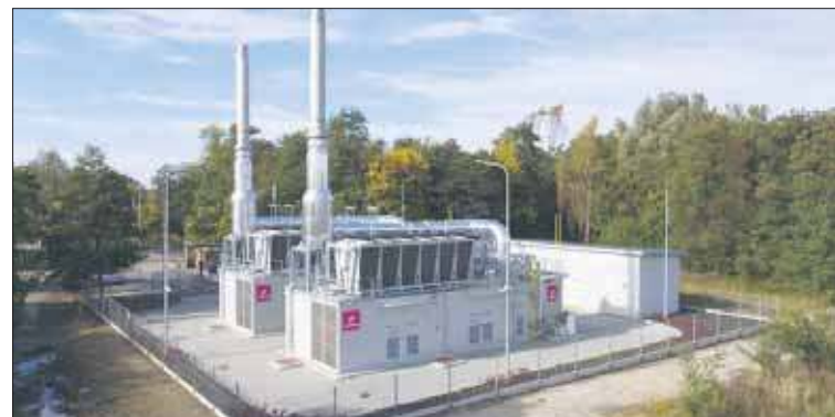
Tauron zamieni kopalniany metan na ciepło i prąd
