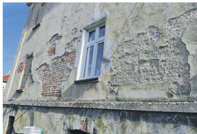
Tynk leci z elewacji
