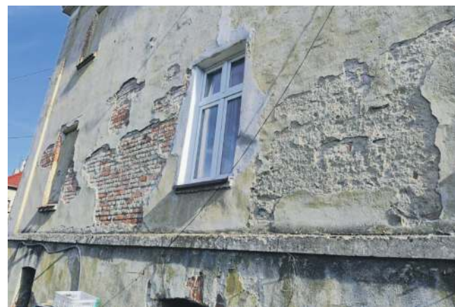
Tynk leci z elewacji
