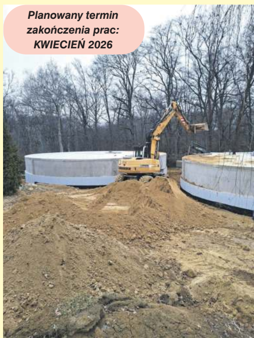
Stacja uzdatniania wody w Machnicach
