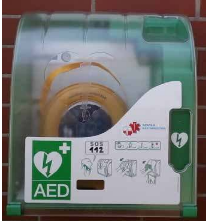
Fot. 3. Defibrylator AED umieszczony w specjalnej szafce na budynku użyteczności publicznej.
