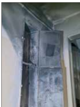
Ogień pojawił się w skrzynce elektrycznej na klatce schodowej. Fot. PSP Zamość
