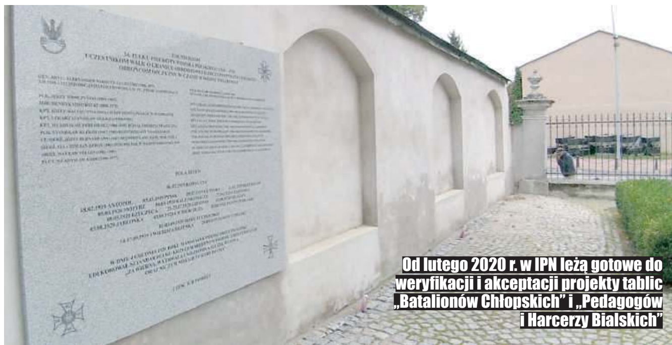
Na murze ogrodzenia klasztornego wisi tylko jedna tablica. Widać miejsca zawilgocone
