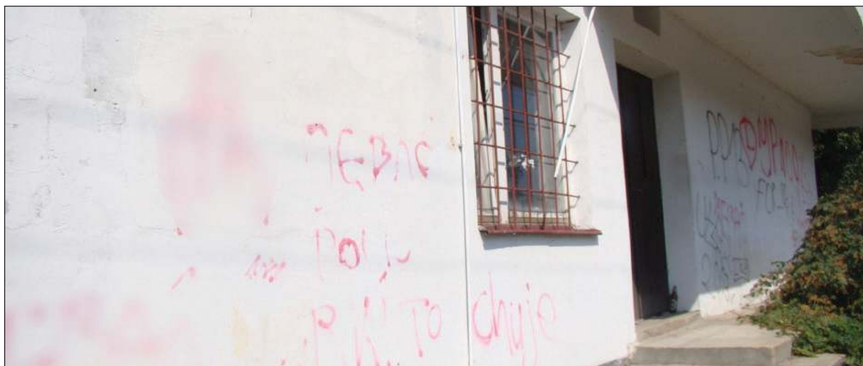
■ Ściany budynku po byłej restauracji „Kosmos” „ozdabiają” wulgarne napisy i seksistowskie rysunki
