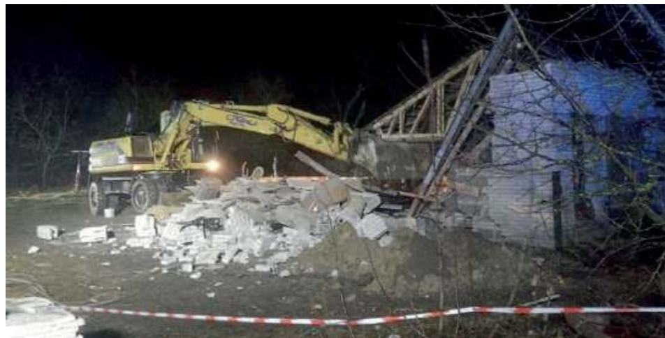
Po wydostaniu ciała mężczyzny konieczna była natychmiastowa rozbiórka budynku, który w każdej chwili mógł się zawalić
