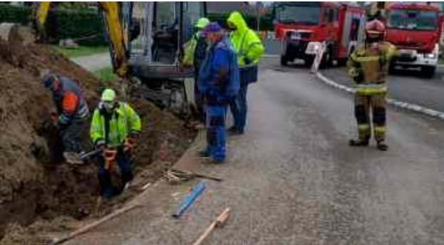
Do uszkodzenia gazociągu doszło podczas prac ziemnych
