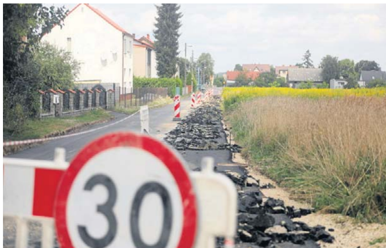
Droga przeorana przez ciągnik ma zostać naprawiona
