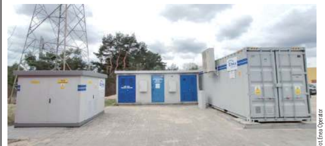
Przy budynkach użyteczności publicznej w gminie Terespol, pojawią się specjalne magazyny energii
