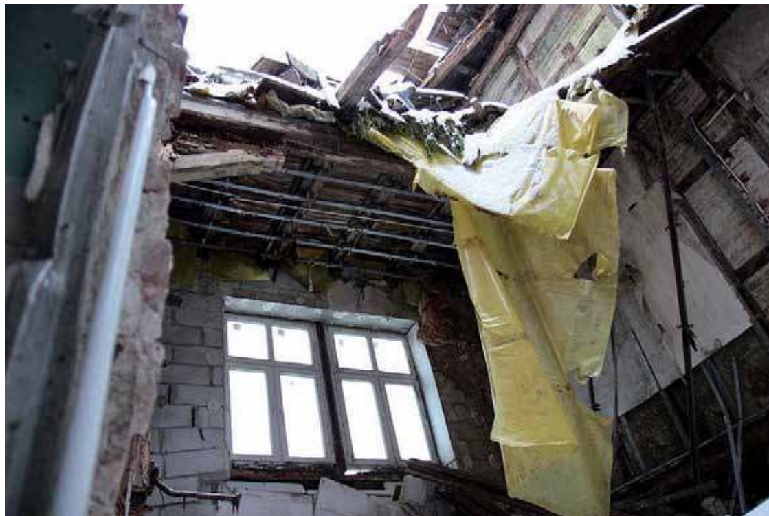
Budynek grozi aktualnie całkowitym zawaleniem
