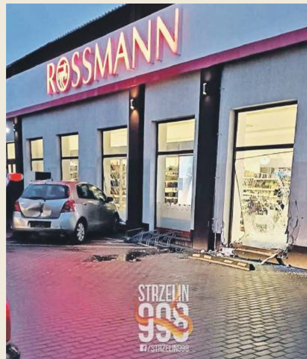
W wyniku zdarzenia uszkodzona została witryna sklepu Rossmann. Foto: Strzelin998
