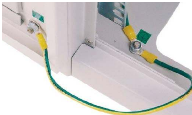
Fotografia 11. Połączenie uziemienia ochronnego wykonane za pomocą przewodów zakończonych końcówkami oczkowymi ( http://t.ly/RLjPt )
