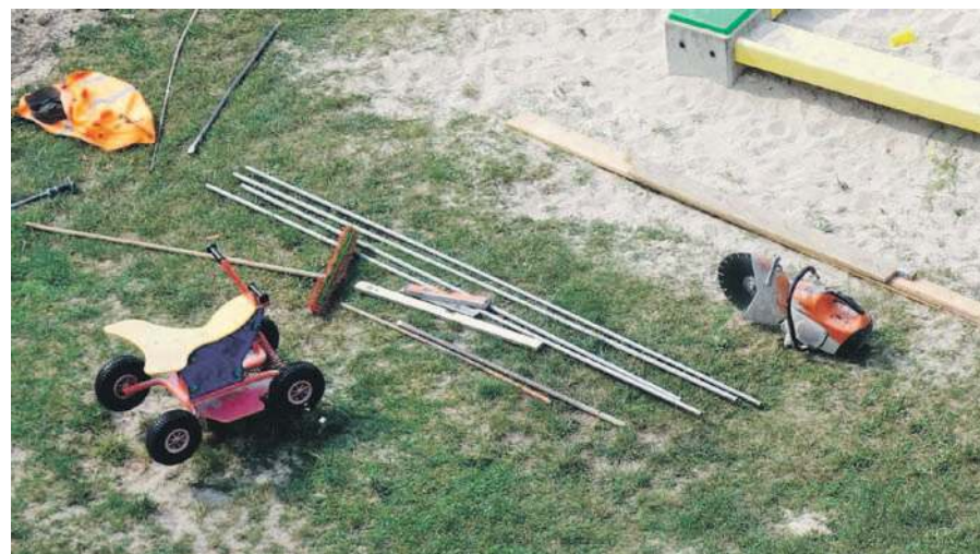
Między piaskownicą a dziecięcym rowerkiem leżała nieosłonięta piła spalinowa do cięcia betonu i deska z wystającymi gwoździami
