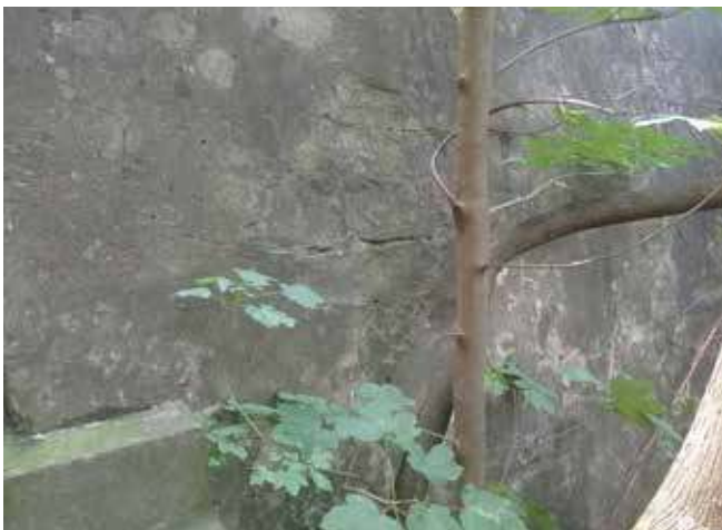
Na murze widać pęknięcia
