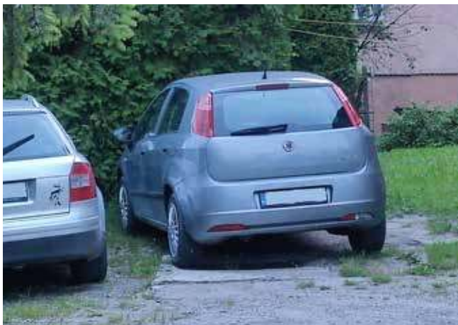
Samochód parkujący na płycie, która uległa uszkodzeniu. Zdaniem Grzegorza Borowskiego parkował na niej tylko ten samochód
