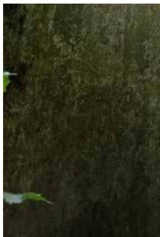
Ściana jest wilgotna i porośnięta mchem
