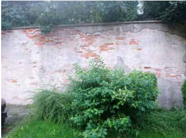
Tynk odpada wielkimi płatami
