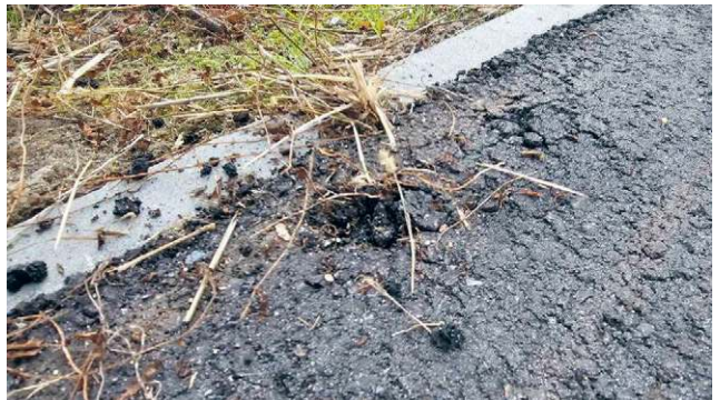
Na temat spękań nawierzchni mieszkańcy alarmowali już pod koniec ubiegłego roku.
