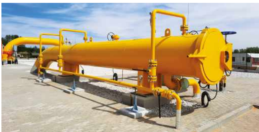
Śluza nadawczo-odbiorcza w Ciecierzycach w lądowej części gazociągu Baltic Pipe. Fot. mat. pras.
