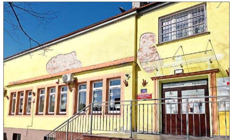
Od frontowej ściany Domu Seniora odpadły wielkie płyty tynku.
