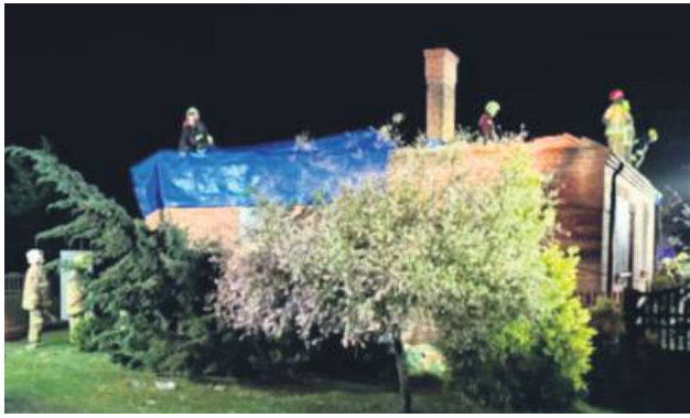
Zaraz po przejściu żywiołu strażacy naciągnęli plandekę, aby tymczasowo chronić budynek przed opadami deszczu.
