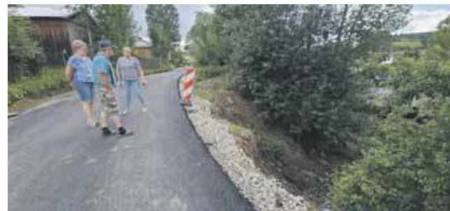
Po ulewie tuż przy drodze powstała niebezpieczna wyrwa.
