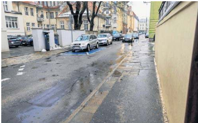
Ulica Murarska już od dawna wymaga remontu
