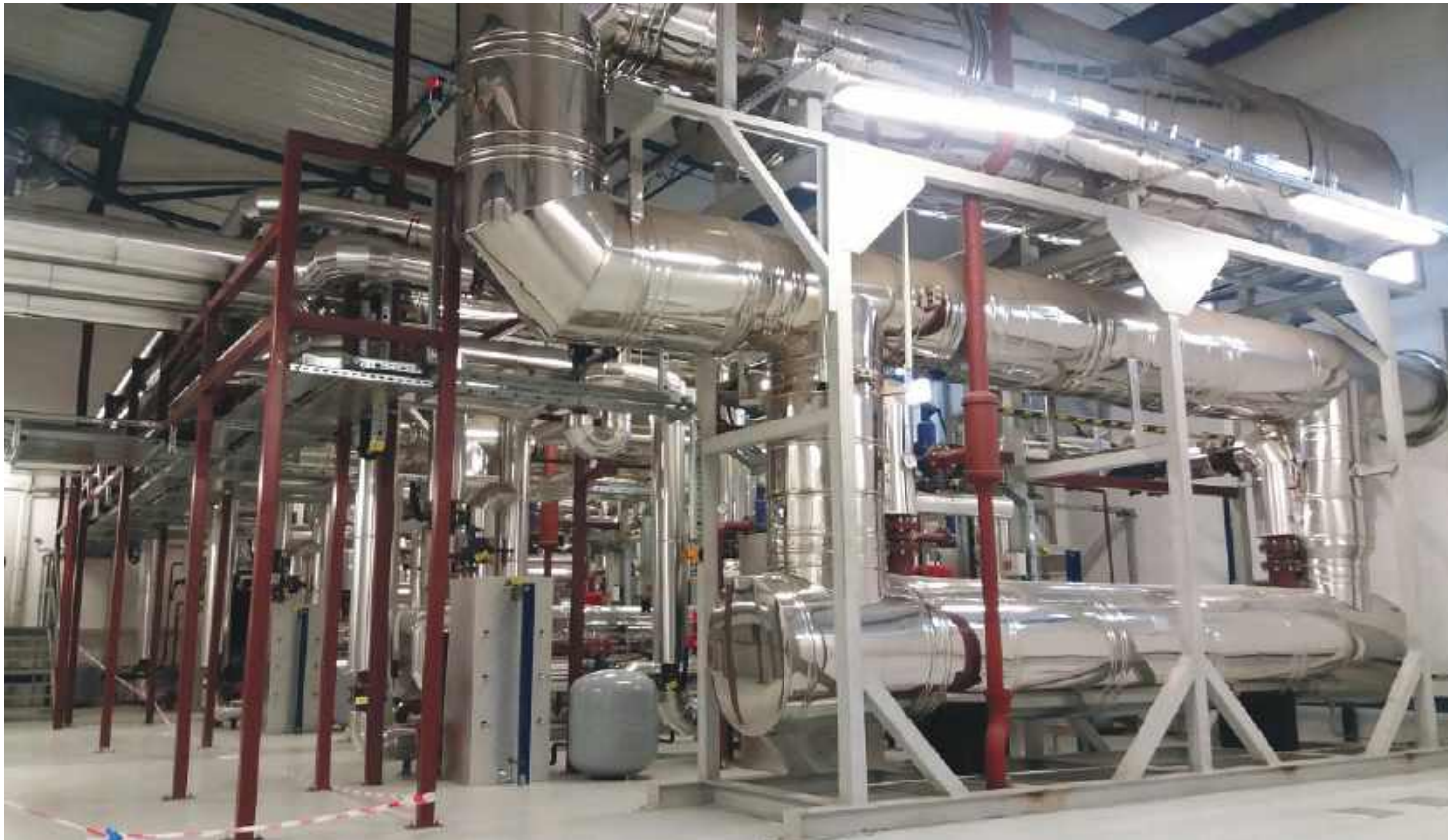
Odzysk ciepła z kogeneracji
