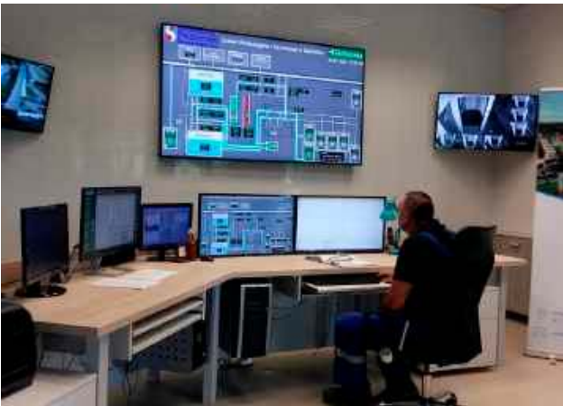
Tak wygląda dyspozytornia zmodernizowanej magistrali
