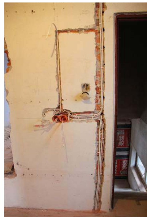
🔧 Przewody zasilające prowadzi się po liniach prostych, w pionie lub poziomo. J. WERNER
