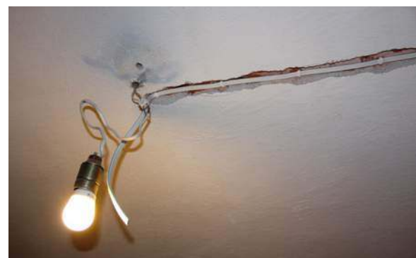
🔧 Płaski przewód wielożyłowy w bruzdzie wykutej w tynku. Starych przewodów nie trzeba usuwać, wystarczy odciąć od nich napięcie. J. WERNER
