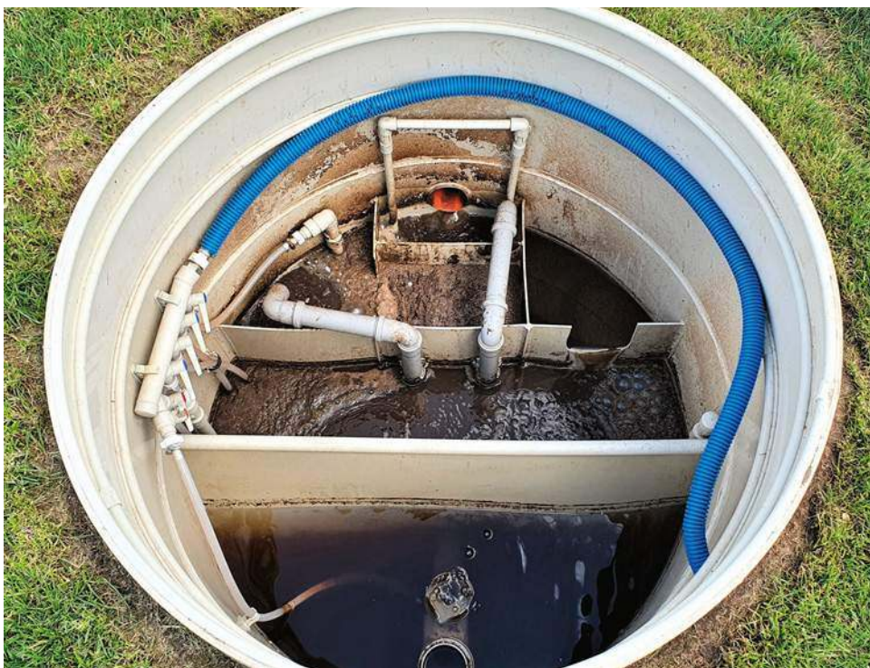
🔦 Wnętrze oczyszczalni biologicznej. EKO HOUSE
