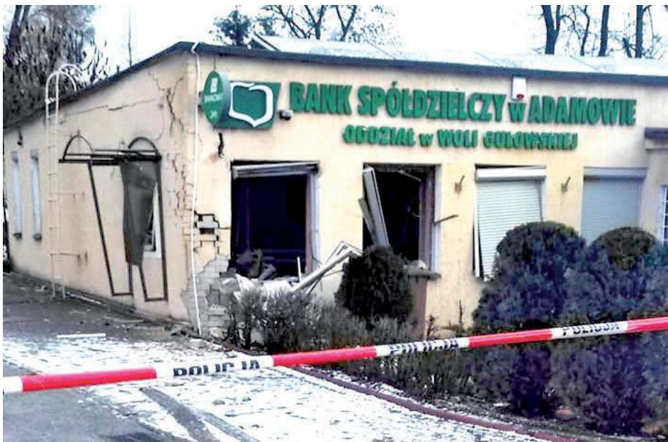
Po wysadzeniu bankomatu z budynku banku wyleciały okna i popękały ściany (fot. OSP Wola Gułowska)
