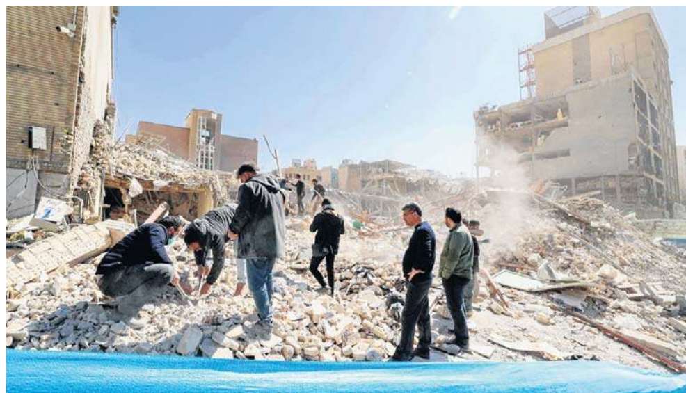
Ludzie oglądają gruzy zavalonego budynku w pobliżu placu Ferdousiego w Teheranie. Ataki Izraela i Stanów Zjednoczonych na Iran trwają od 28 lutego
