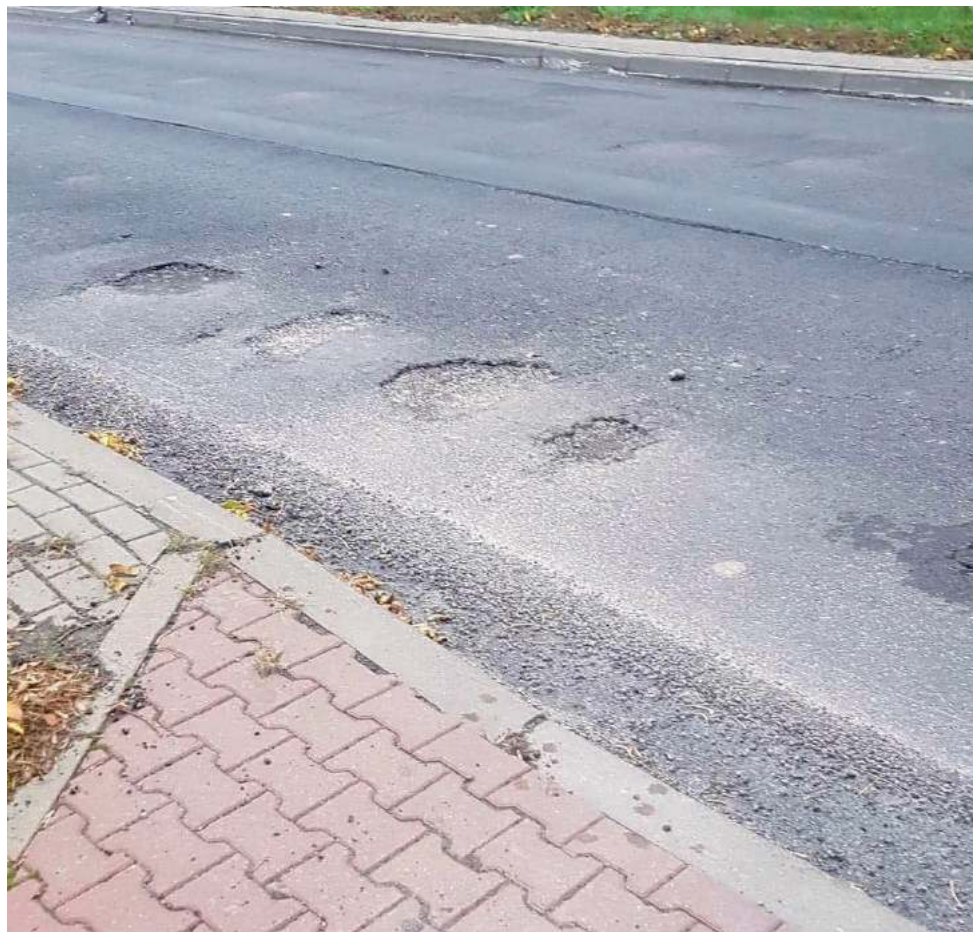
A tak wygląda „nowy” asfalt na Kościuszki
