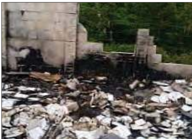
Pogorzelisko nadal jest nieuporządkowane, a budynki są w takim stanie, jak na drugi dzień po pożarze (fot. Elżbieta Lewtak)
