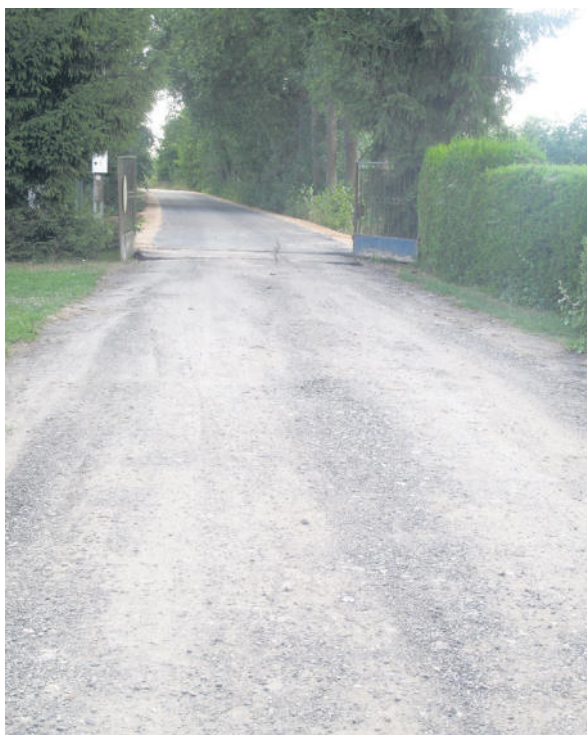
Droga w Topórku. Tyle asfaltu zabrakło
